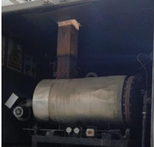
FOTO ILUSTRATIVA INTERCAMBIADOR DE CALOR
