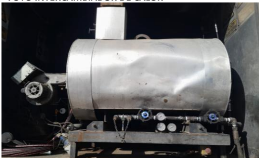
FOTO INTERCAMBIADOR DE CALOR
