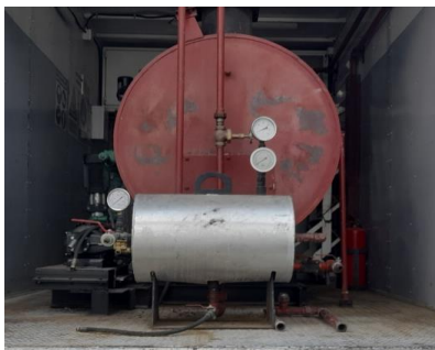
FOTO INTERCAMBIADOR DE CALOR
