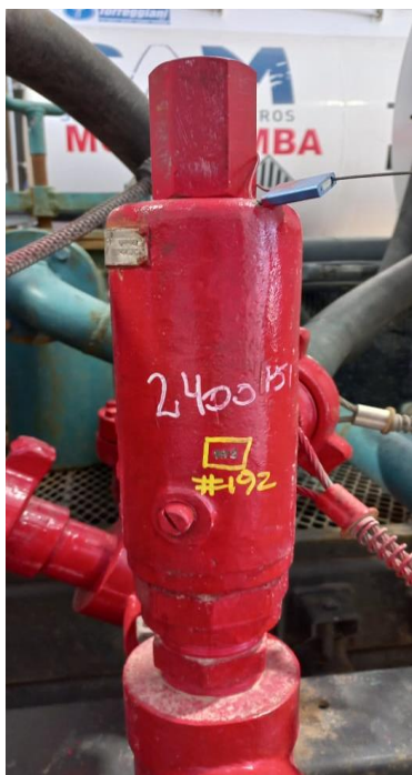
FOTO VALVULA DE SEGURIDAD
